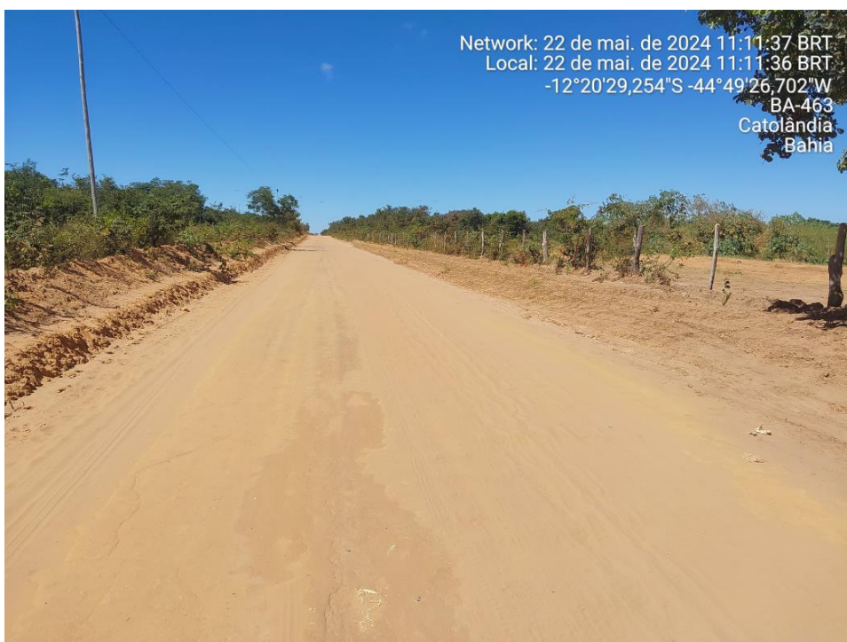
Figura 6. Condições de trafegabilidade das vias externas.
